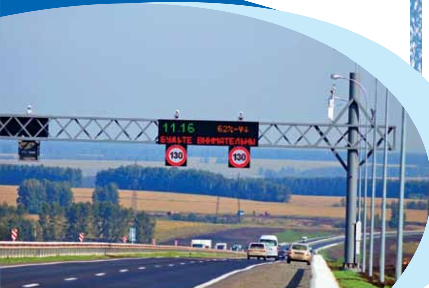
Интеллектуальная транспортная система на автомобильной дороге Новосибирск – Ленинск-Кузнецкий – Кемерово – Юрга
