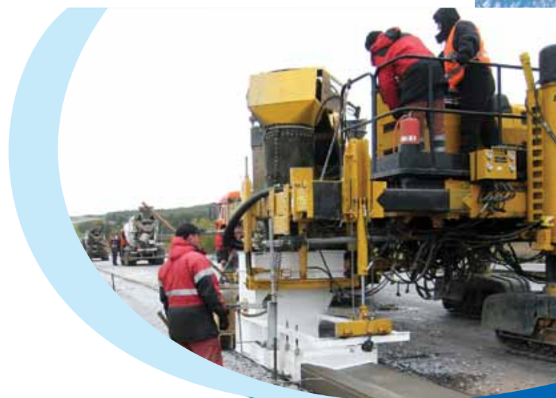
Устройство бетонных монолитных прикромочных лотков на автомобильной дороге Новосибирск – Ленинск-Кузнецкий – Кемерово – Юрга
