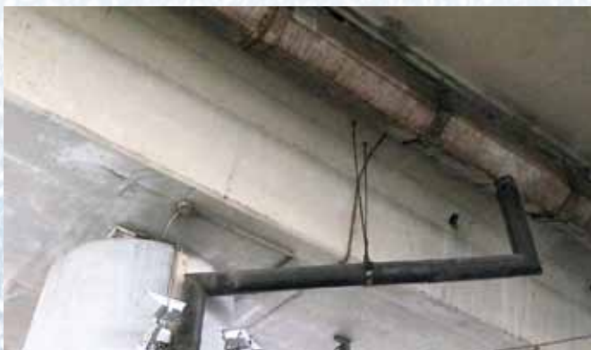
Преждевременная коррозия оцинкованного водоотводного лотка
