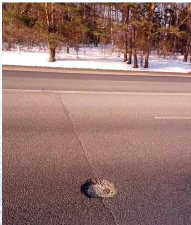
Выбоина на стыке асфальтобетонного покрытия без использования стыковочных лент
