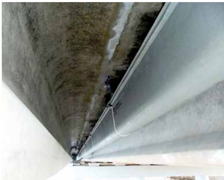
Подвесной композитный лоток между балками пролетного строения
