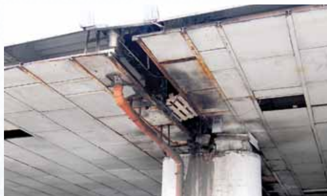
Многочисленные протечки и коррозия конструкции пролетного строения
