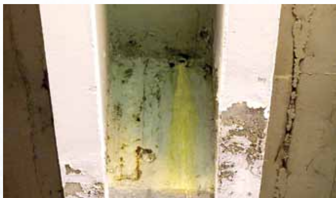
Разрушение конструкции пролетного строения из-за протечек
