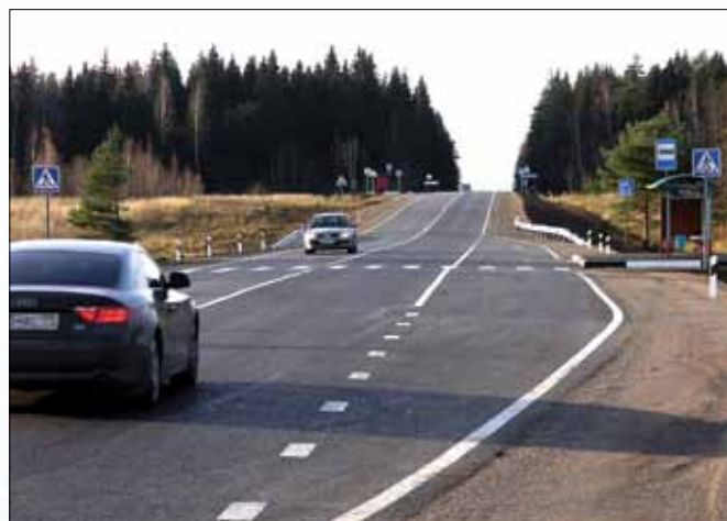
Устройство поверхностной обработки на автомобильной дороге Тетерино – Мышкино – Поречье в Можайском районе
