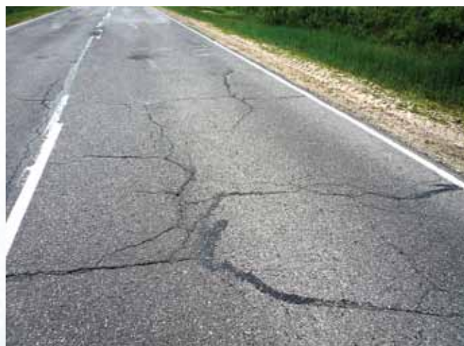
Рис. 1. Отраженные трещины на асфальтобетонном покрытии
