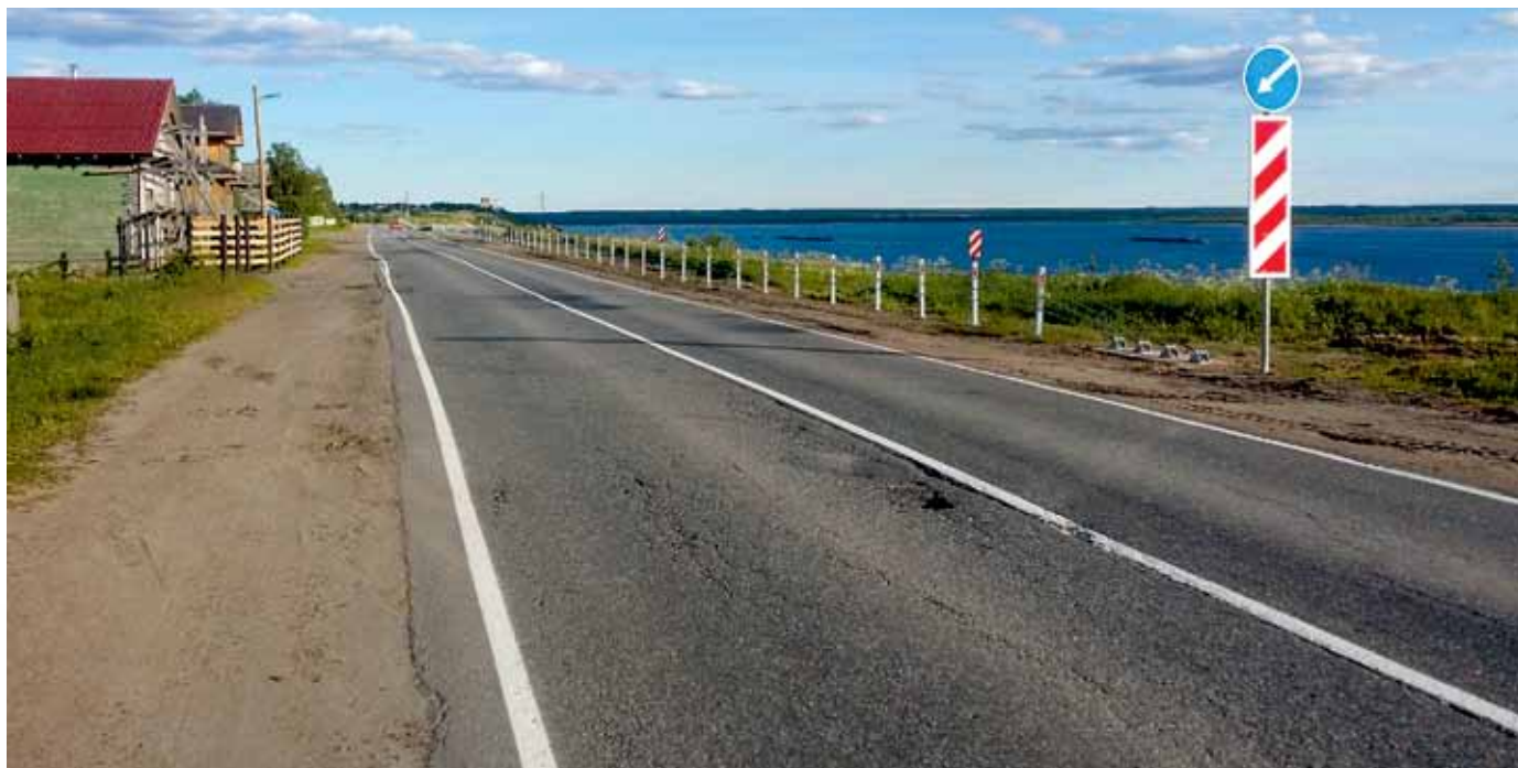
Тросовое дорожное ограждение на обочине автомобильной дороги в Архангельской области
