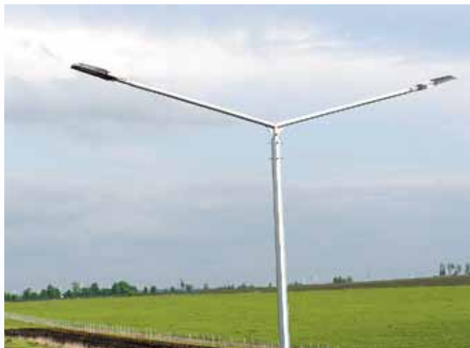
Светильники SKU 01-180-001 на М-4 «Дон» – обход Новая Усмань – Рогачевка
